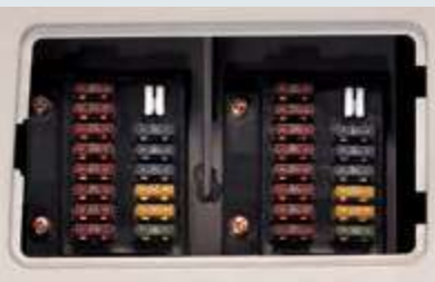
Cómoda ubicación de la caja de fusibles
